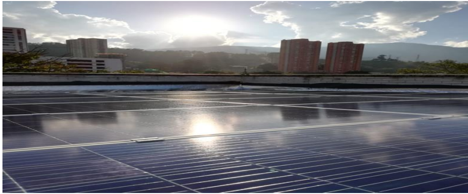
Aprovechamiento de la energía solar para el servicio de energía.
