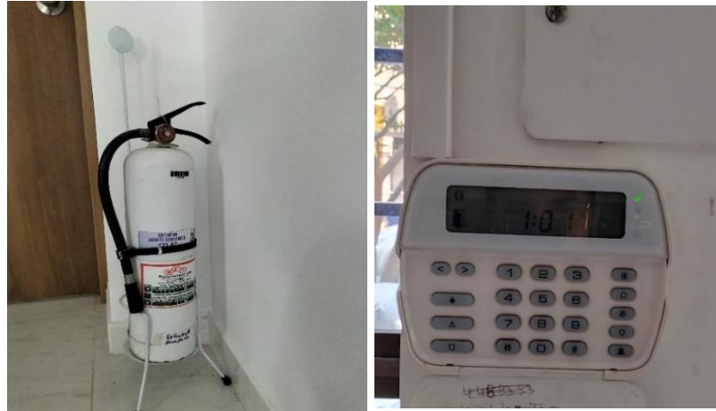
Imagen 7. Sistema de Seguridad y Emergencias EAPSA
